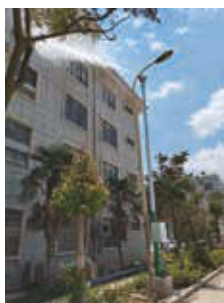
Fog-pile dust suppression system 霧樁抑塵系統
