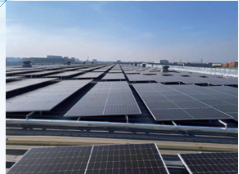
安徽省蕪湖市豐泰產業園內的分佈式 光伏發電站
