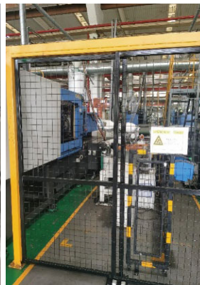
塑膠廠自動化機械 安全連鎖裝置
