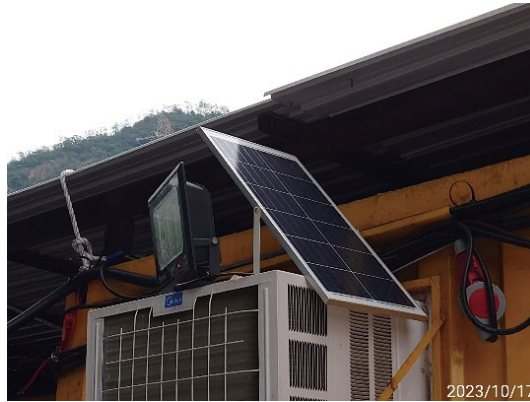
工地辦公室的太陽能照明
