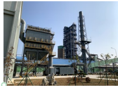
臭气处理装置
