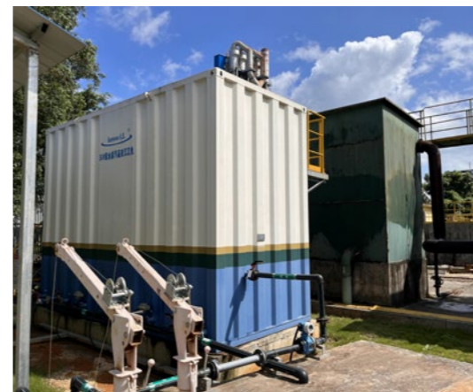
罗定水泥废水零排放项目
