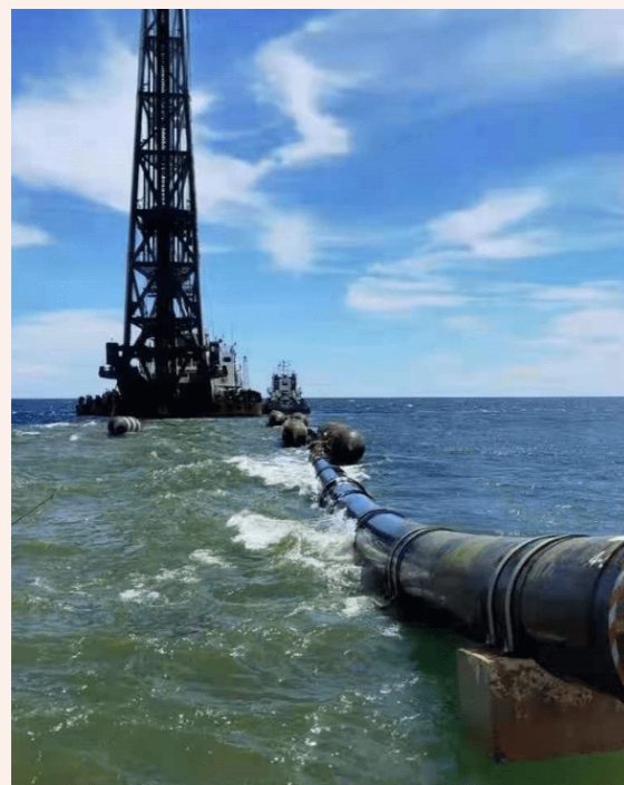
馮家灣取水工程
